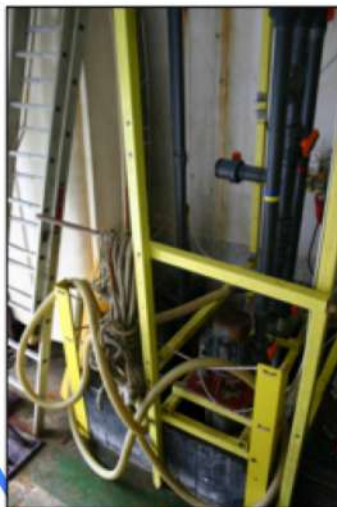
Pompa alimentazione utenze acqua mare
