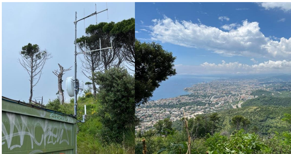
Rete sperimentale: il LoraWan gateway sul Monte Moro (Genova)
