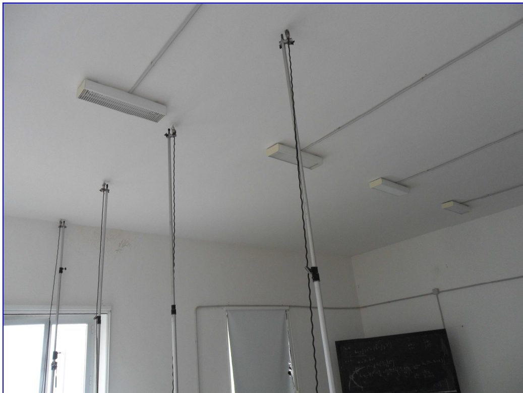
Foto n.2 – Panoramica dei sensori di spostamento.
